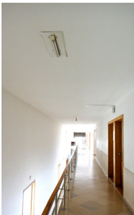
Figura 121 Iluminação das zonas de circulação da Escola Secundária de Educação em Setúbal
