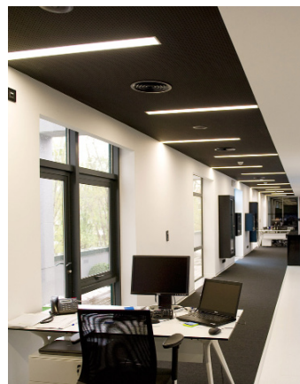
Figura 79 Luminárias lineares fluorescentes
